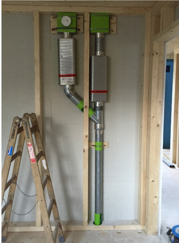
Lüftungsverteilung in der Innenwand
