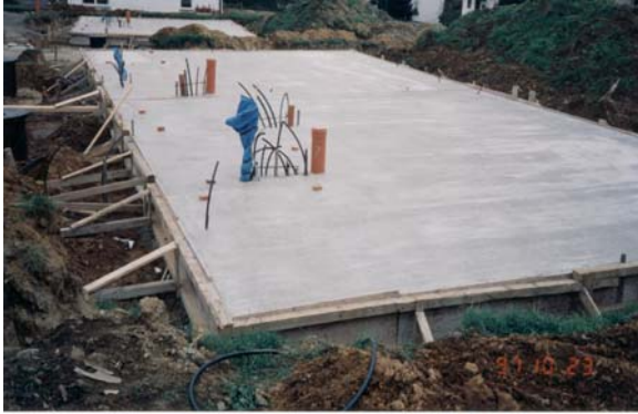
Bodenplatte mit Vorfertigung aller Ver- und Entsorgungsleitungen, zur Sicherstellung der Luftdichtigkeit und Wärmebrückenfreiheit
