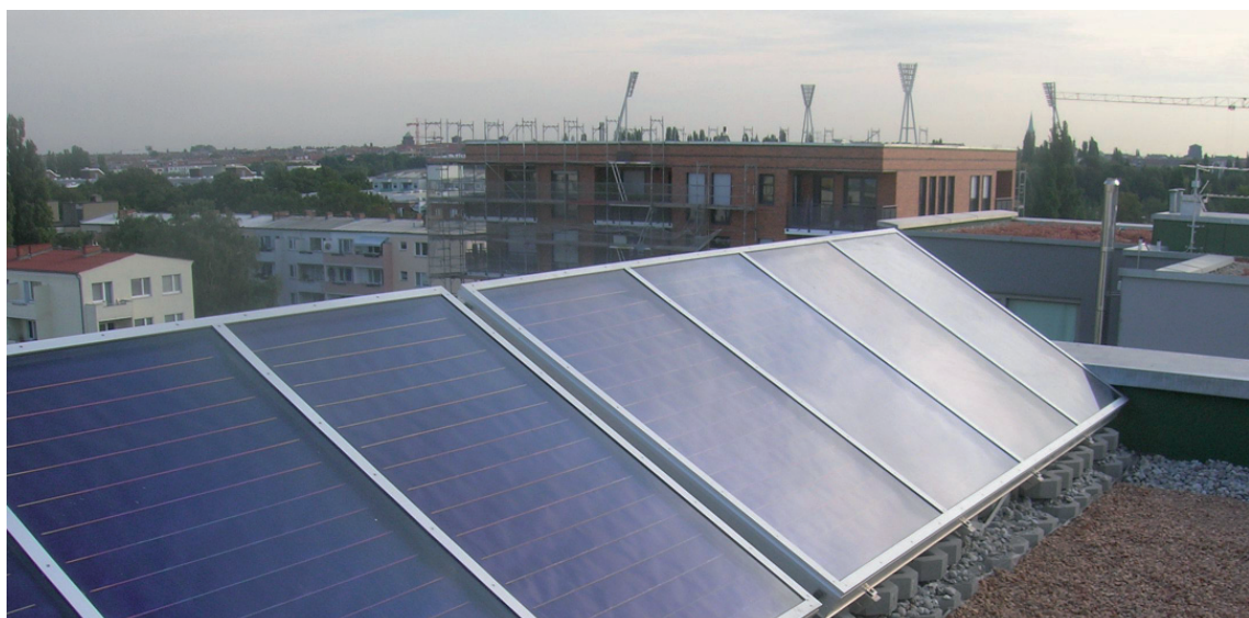
25. Flachkollektoren auf dem Dach für Warmwasser und Heizungsunterstützung
