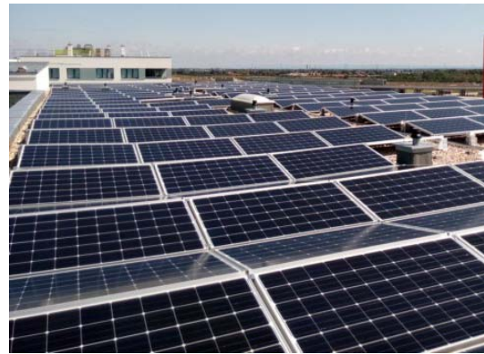
Studierenden-Wohnheim GreenHouse, Photovoltaikanlage auf den Flachdächern.
