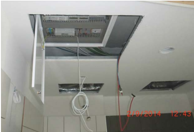
Studierenden-Wohnheim GreenHouse, Messelektronik in der Decke Badezimmer. Im Hintergrund sind Revisionsöffnungen für die Volumstromregler der Lüftung erkennbar. (Foto: aap.architekten).
