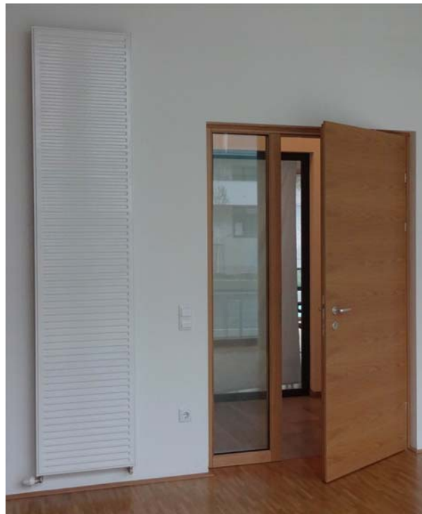
Studierenden-Wohnheim GreenHouse, Haustechnikraum. Heizkörper im Musikübungsraum im Erdgeschoss. (Foto: aap.architekten).
