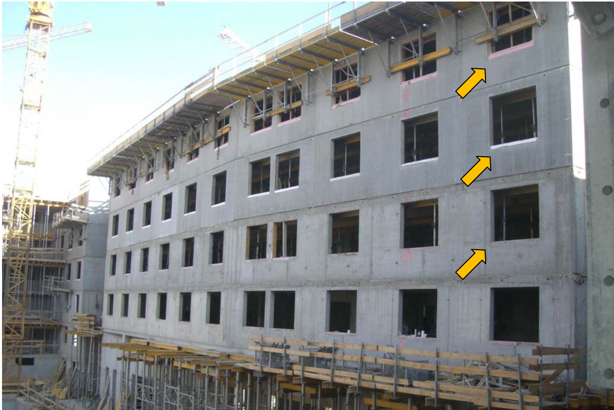
Studierenden-Wohnheim GreenHouse, Außenwände. Im Bereich der Fensterbänke wurde ein Dämmstreifen eingelegt. (Foto: aap.architekten).
