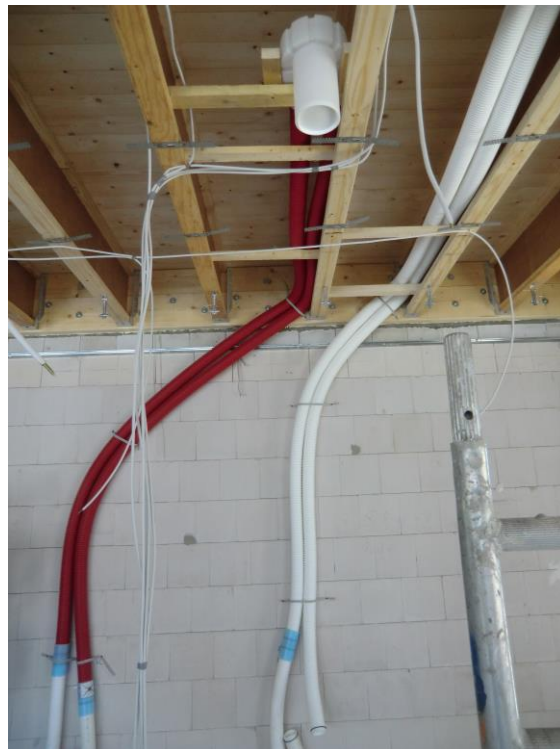
Lüftungsleitungen in der Dämmebene
