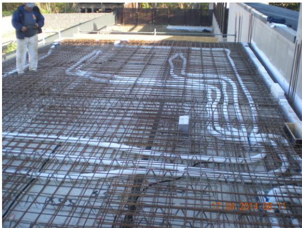
Lüftungsleitungen in der Decke
