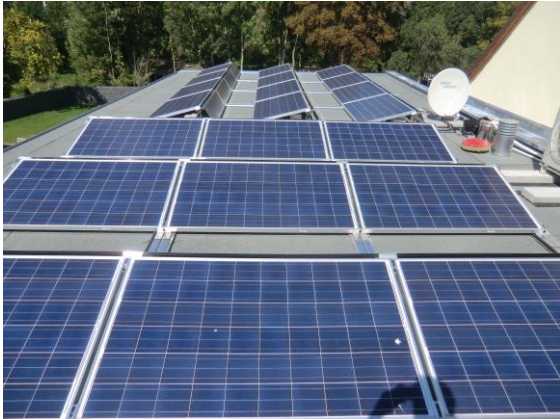
Photovoltaik auf dem Dach
