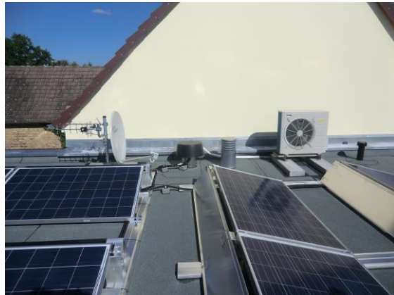
Außengerät Wärmepumpe auf dem Dach
