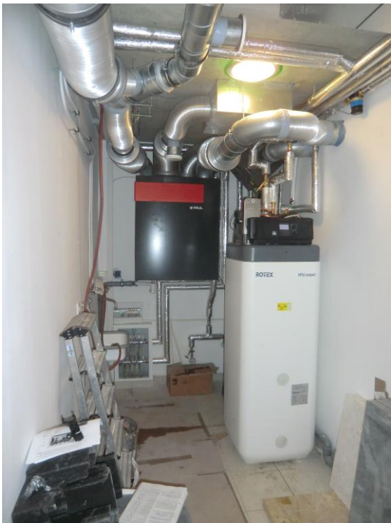
Technikraum mit Speicher und Wärmerückgewinnungsgerät
