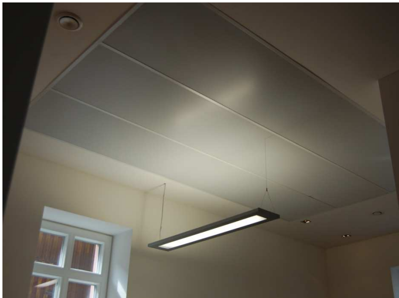
Kühl- und Heizdecke
