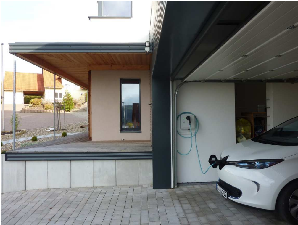
Solartankstelle in der Garage zeigt die Beladung des Elektroautos mit PV-Strom.
