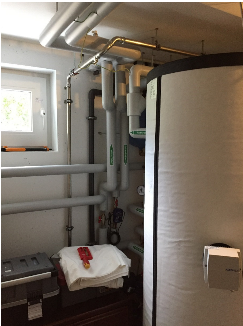
Pufferspeicher im Technikraum
