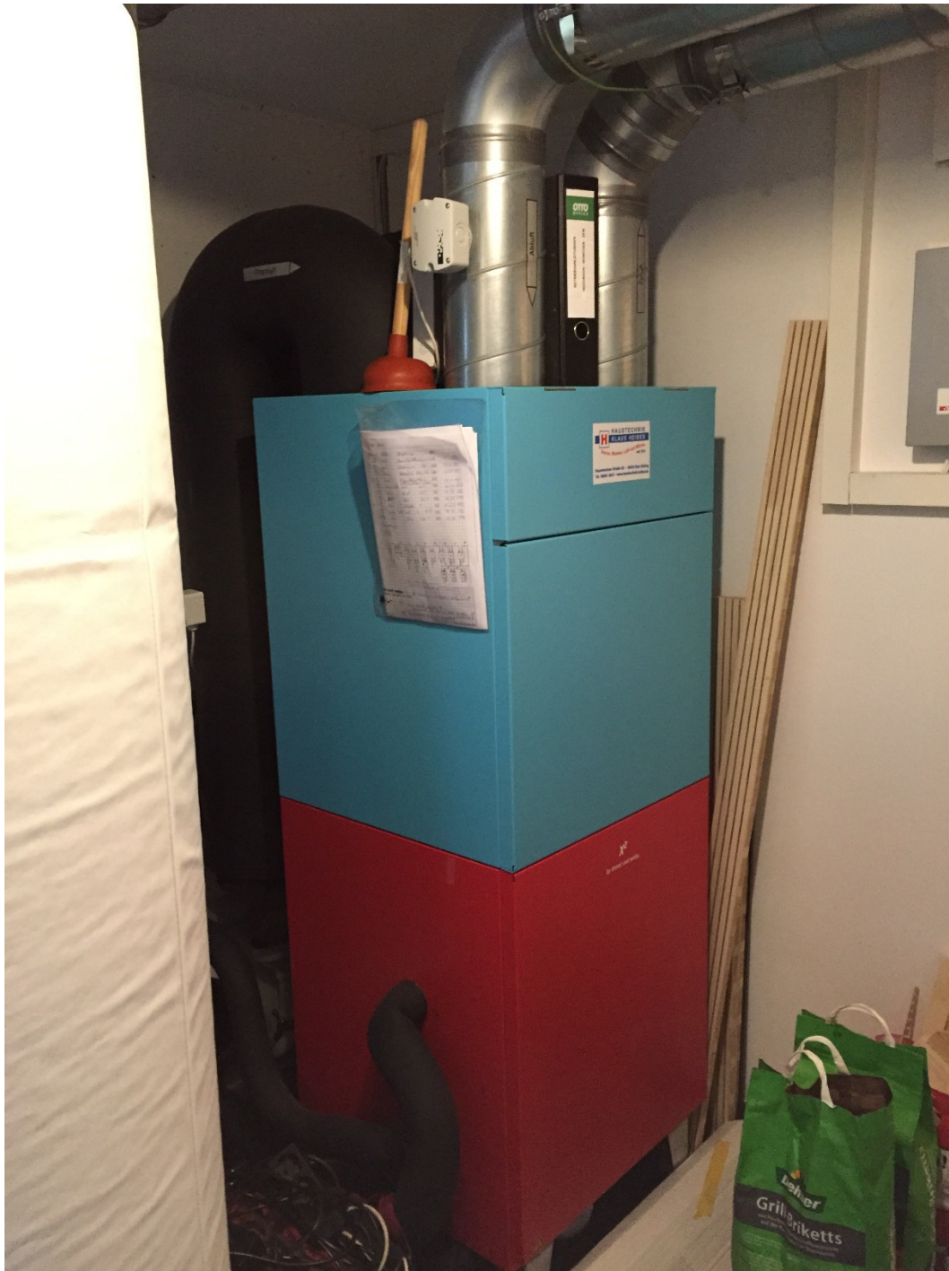
Kompaktgerät x 2 S5 im Technikraum
