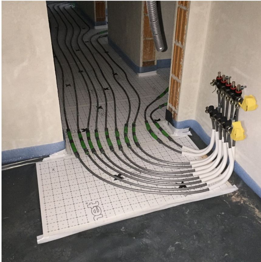
Fußbodenheizungs- verteilung UG
