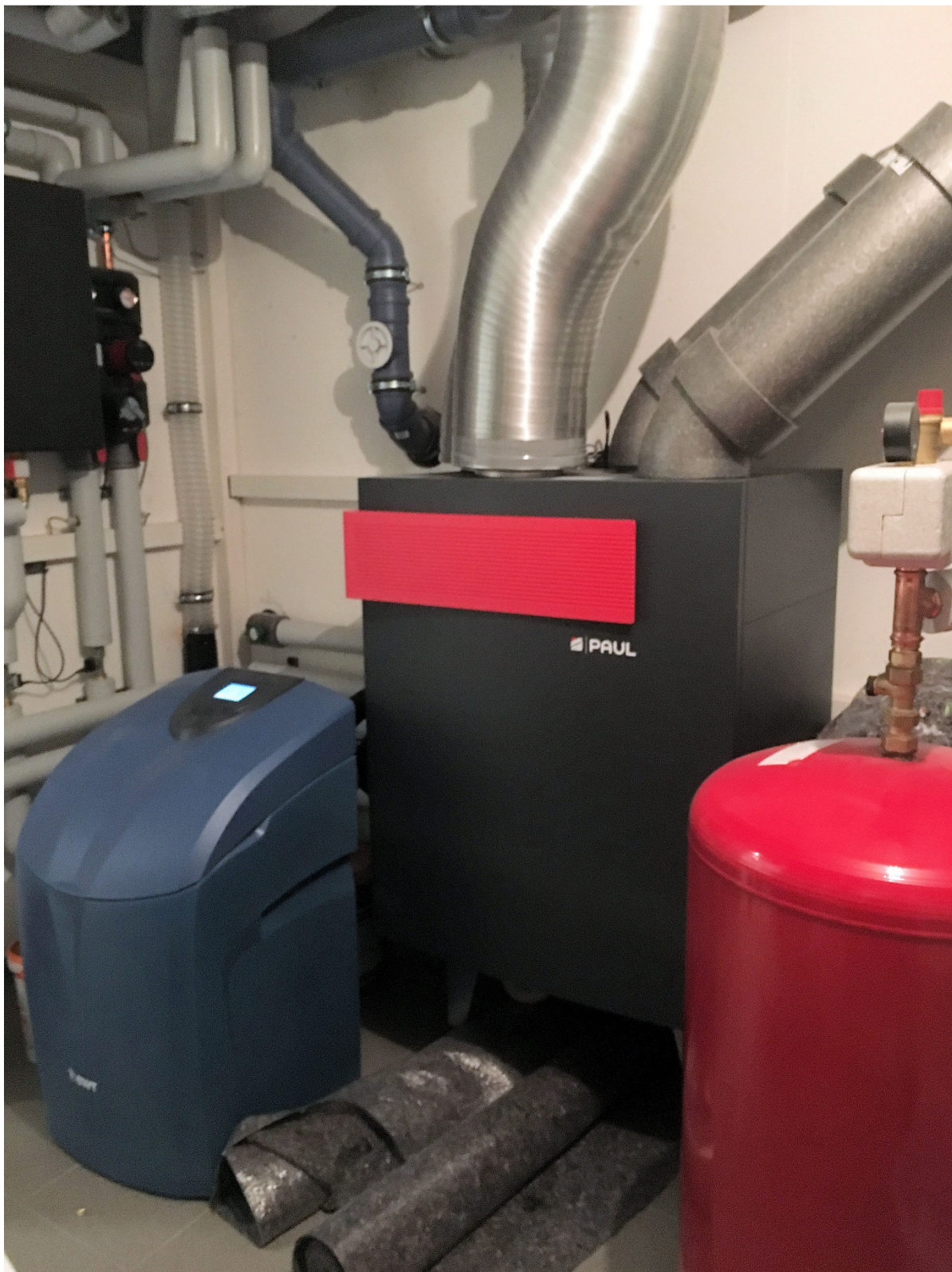
Lüftungsgerät Fabr. Paul zwischen Entkalkungsanlage und Ausdehnungsgefäß der Heizung
