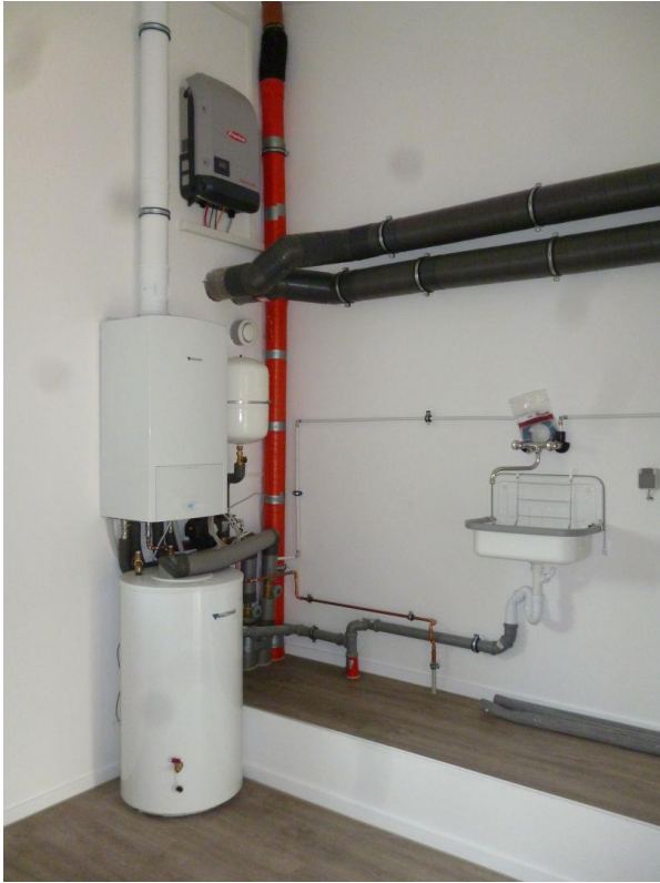
Technikraum Passivhaus Grundweg Kaltenkirchen (Foto: Architekturbüro Thyroff-Krause)
