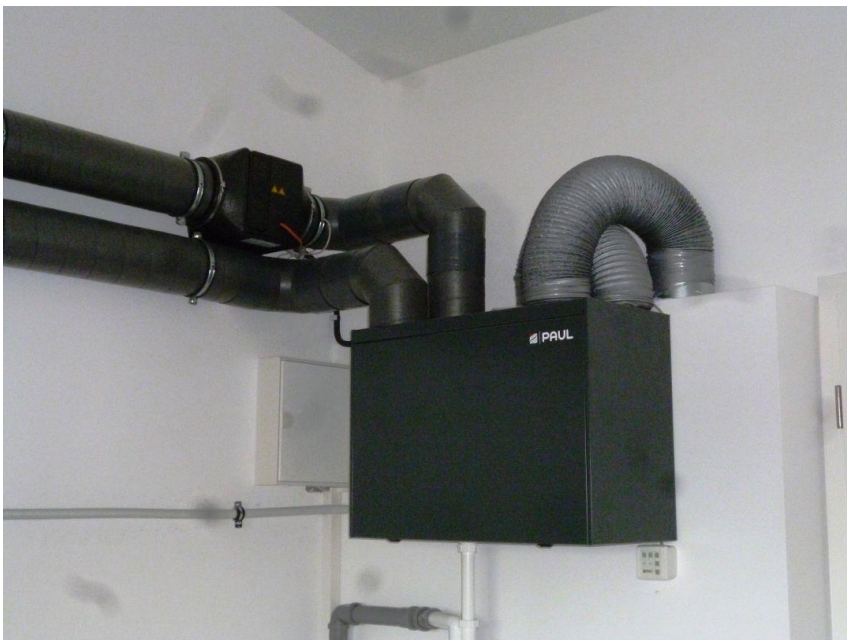
KWL-Gerät mit Anschlüssen oben und Regelung direkt unterhalb des Gerätes Passivhaus Grundweg, Kaltenkirchen
