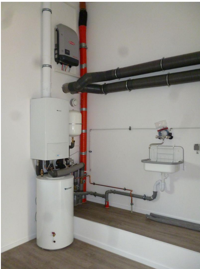
Gas-Brennwerttherme mit Pufferspeicher darunter; an der Wand ist der Wechselrichter der PV-Anlage zu erkennen Passivhaus Grundweg, Kaltenkirchen
