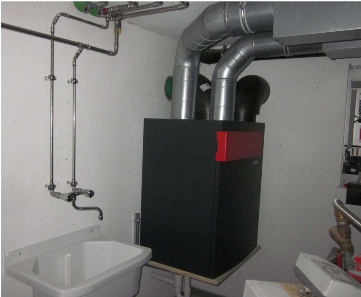
Paul novus 300 auf Podest mit kurzen Fortluft- und Außenluftrohren
