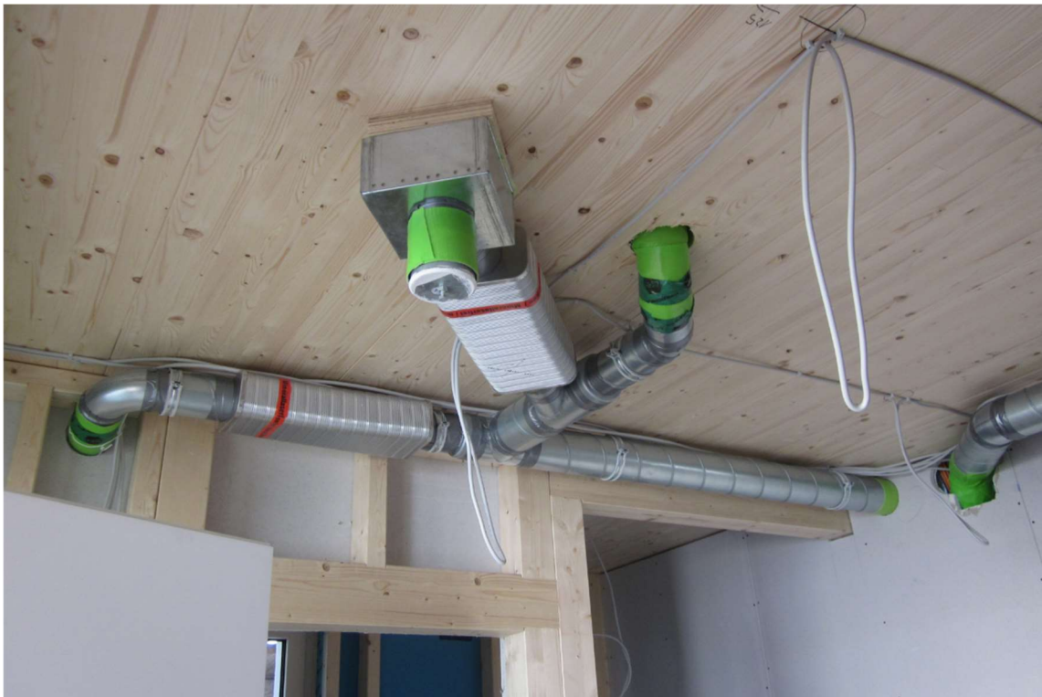
Kanalführung mit Schalldämpfer und Luftauslass im EG (abgeh. Decke folgt)
