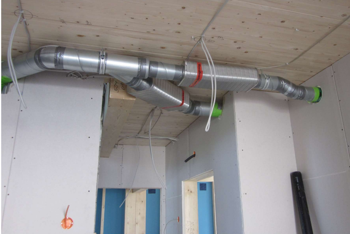
Kanalführung mit Schalldämpfer im OG (abgeh. Decke folgt)
