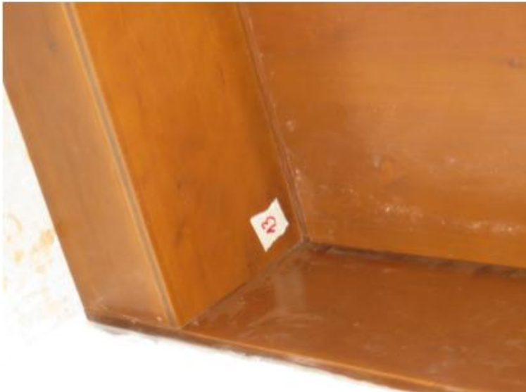
Untere Schließfuge der Fenster an der Westfassade Raum 022
