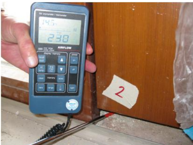
Lufteintritt untere Schließfuge und Stulp Eingangstür EG Fassade Nord
