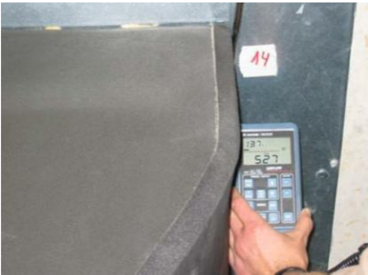
Außenluftkanal Anschluss nach außen
