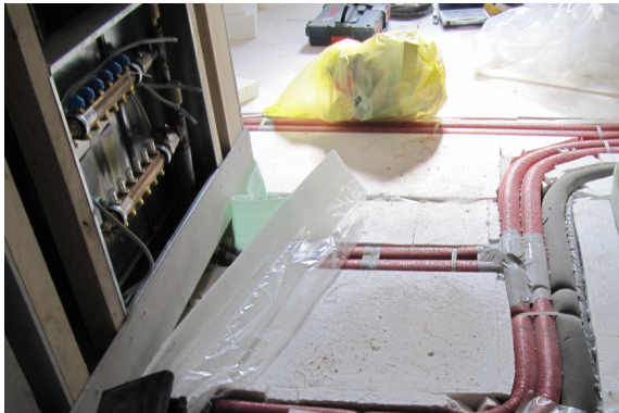
Heizungsrohrführung in Estrichdämmebene
