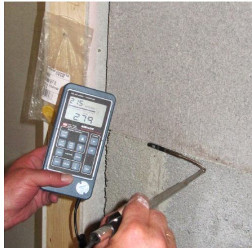
Leckage Schornstein (Schornstein wurde anschliessend verputzt)
