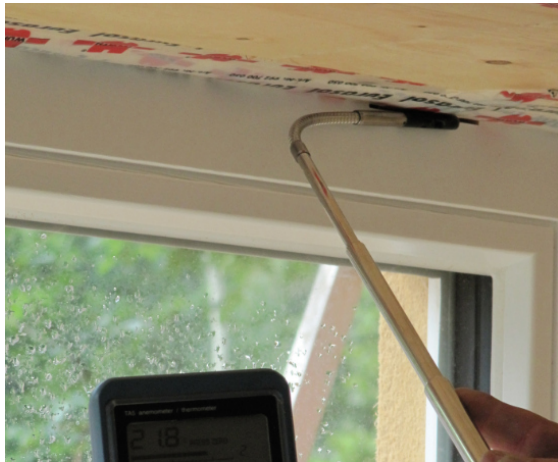
Leckage Fensterlaibung verputzt)
