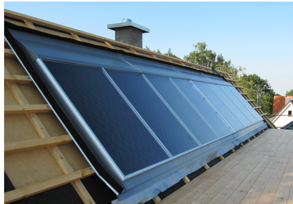
Solarthermie auf dem Süddach
