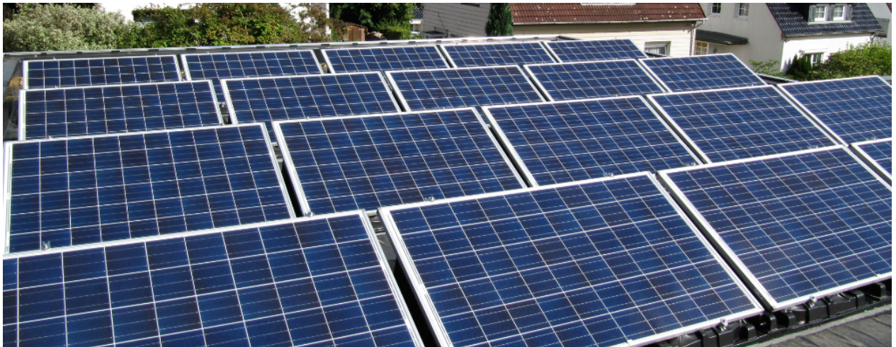
PV Dach D48 (Foto:keenco3)
