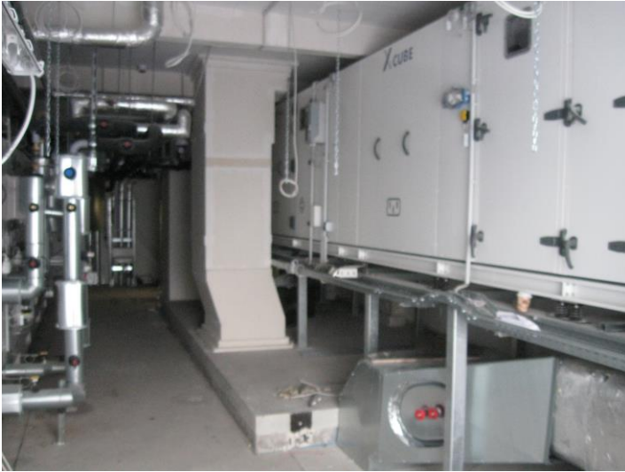
Foto der Lüftungszentrale auf dem Dach
