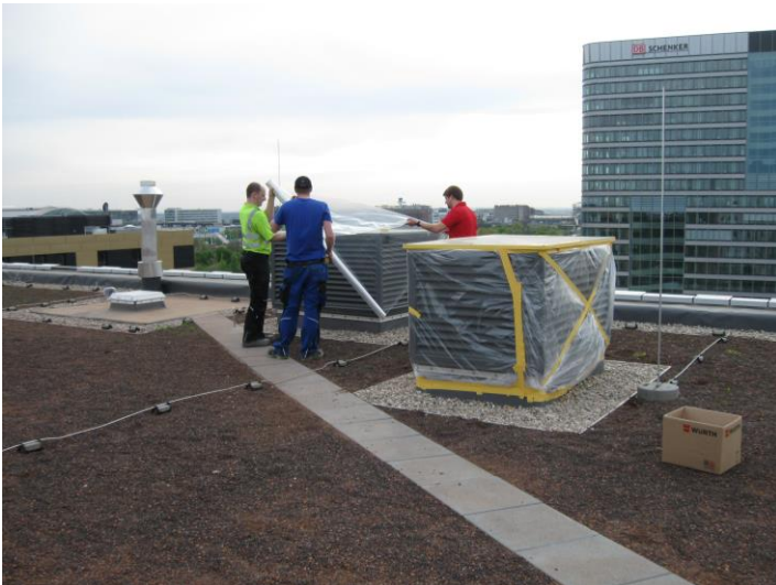
Foto der Lüftungsöffnungen auf dem Dach. Abdichtung für die blower door Messung
