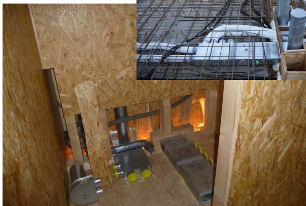
Verteiler für Leitungsnetz auf der Holzbalkendecke (fürs EG)
