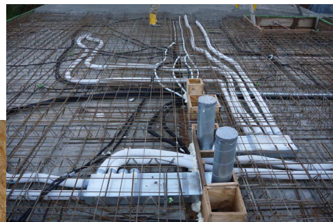
Verteiler für Leitungsnetz auf der Betondecke über UG (fürs UG)
