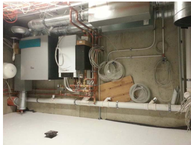
Der Schwarze Kasten rechts neben der Wärmepumpe ist der gedämmte 25L Pufferspeicher für die Fußbodenheizung
