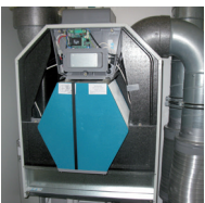
Komfortlüftung mit Wärmeübertrager
